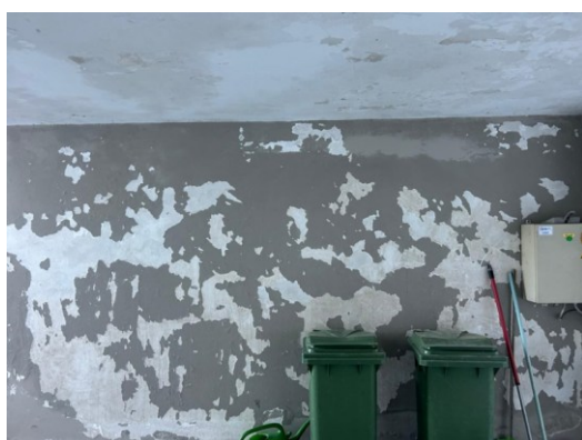
Sfogliamento e distacco della vernice sulle pareti interne
