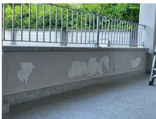
Distacco dell'intonaco sulla parete dei loculi
