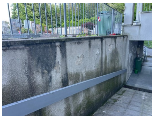
Umidità di risalita nella rampa d'accesso al piano seminterrato
